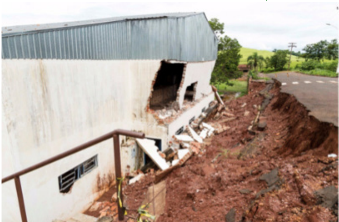
Figura 5-40 - Deslizamento induzido em aterro no município de Telêmaco Borba.
