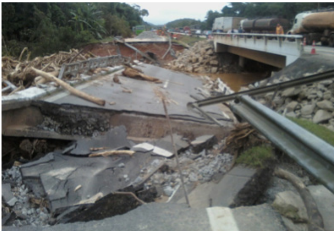
Figura 5-37 - Ponte na BR-277 sobre o rio Jacaré, no município de Paranaguá, destruída por fluxos de detritos em março de 2011.
